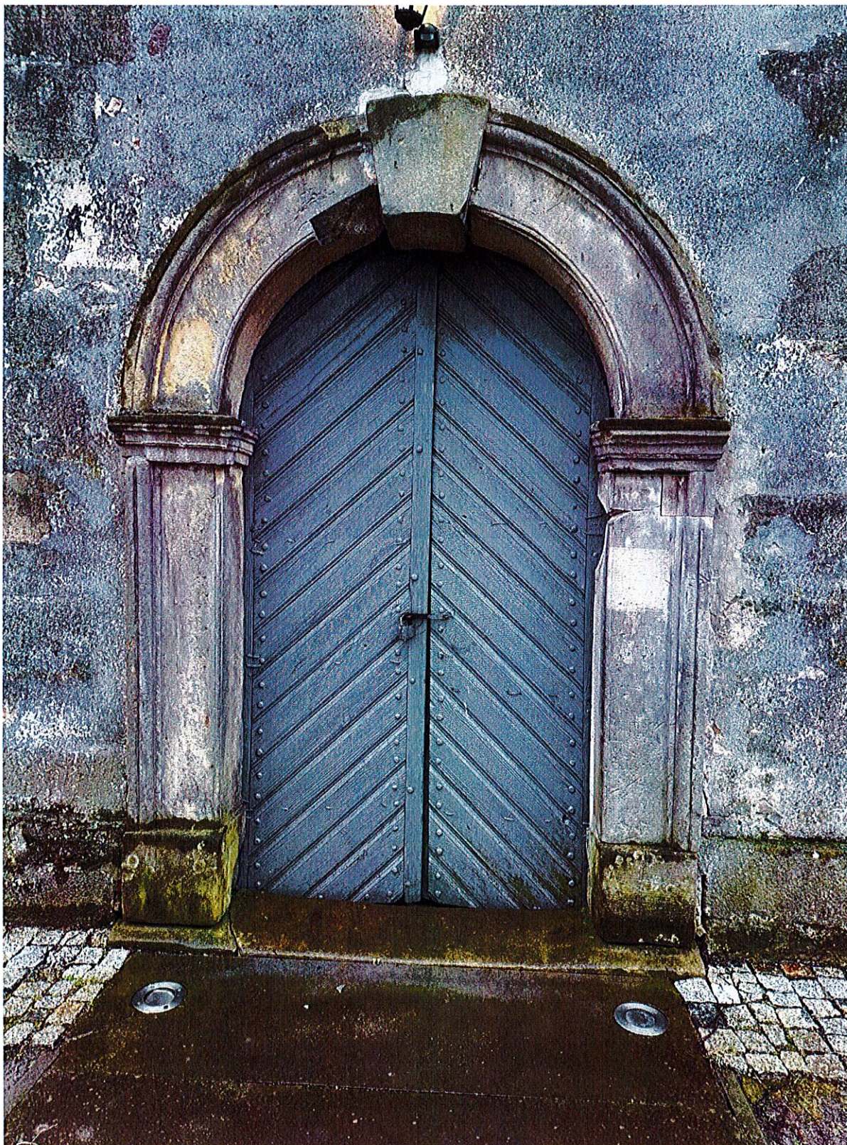
Portal główny - stan z lutego 2024 r. Widoczne ubytki formy rzeźbiarskiej, zabrudzenia powierzchni, działalność mikroorganizmów, dezintegrację struktury kamienia. Autor fot. Katarzyna Pakuła
