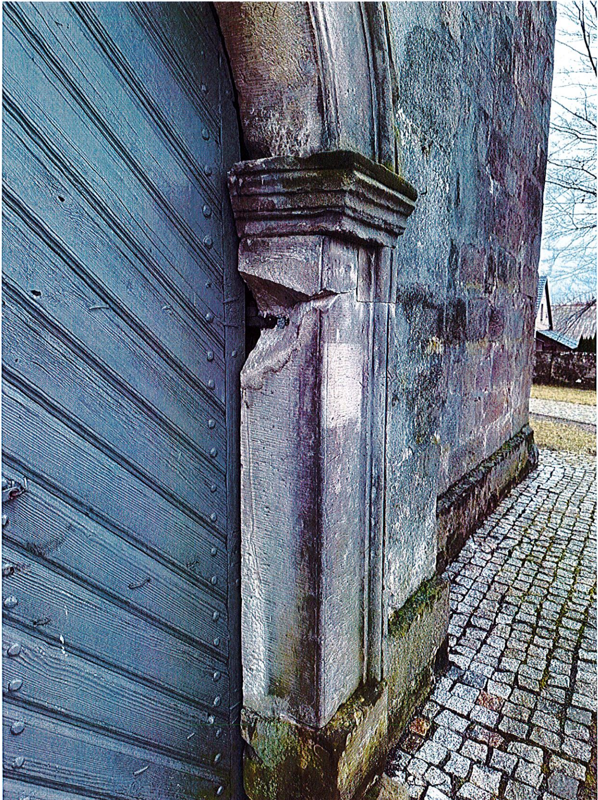
Portal główny - stan z lutego 2024 r. Na prawy węg. Widoczny ubytek formy rzeźbiarskiej odsłaniający zawias drzwi; zabrudzenia powierzchni, działalność mikroorganizmów (dolne partie). Autor fot. Katarzyna Pakuła
