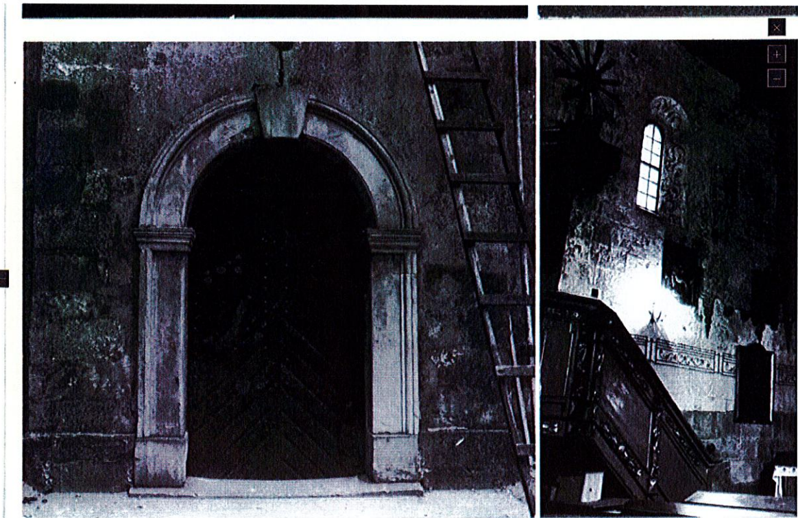
Portal główny - stan z lipca 1990 r., Karta biała zabytku , autor: Jan Maraśkiewicz widoczne uzupełnienie fragmentu z profilowaniem oraz ubytek w partii łuku.
