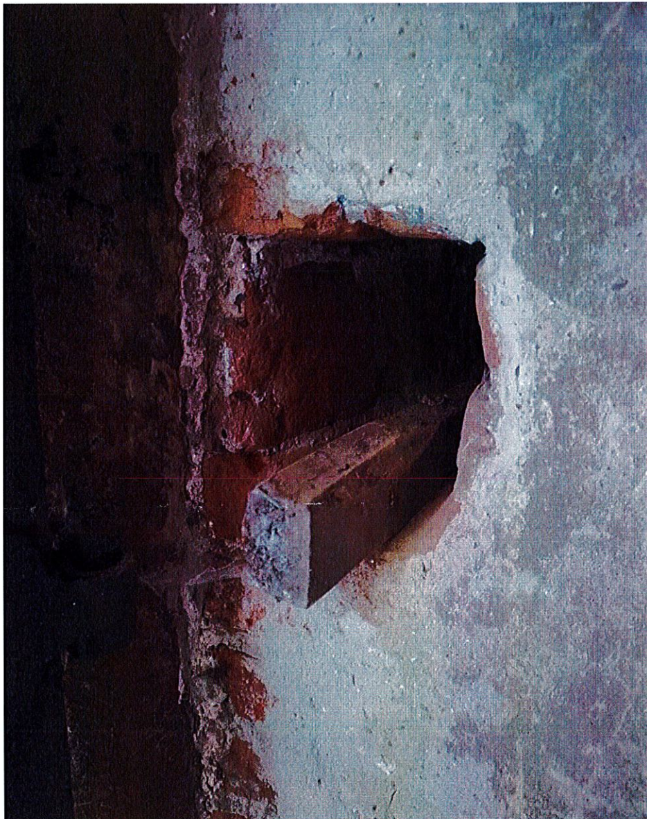
Pozostałości po blokadzie drzwi, widoczne gniazdo montażowe oraz fragmenty drewna w nich umiejscowione, stan z czerwca 2024 r. Autor fot. Iwona Martynowicz
