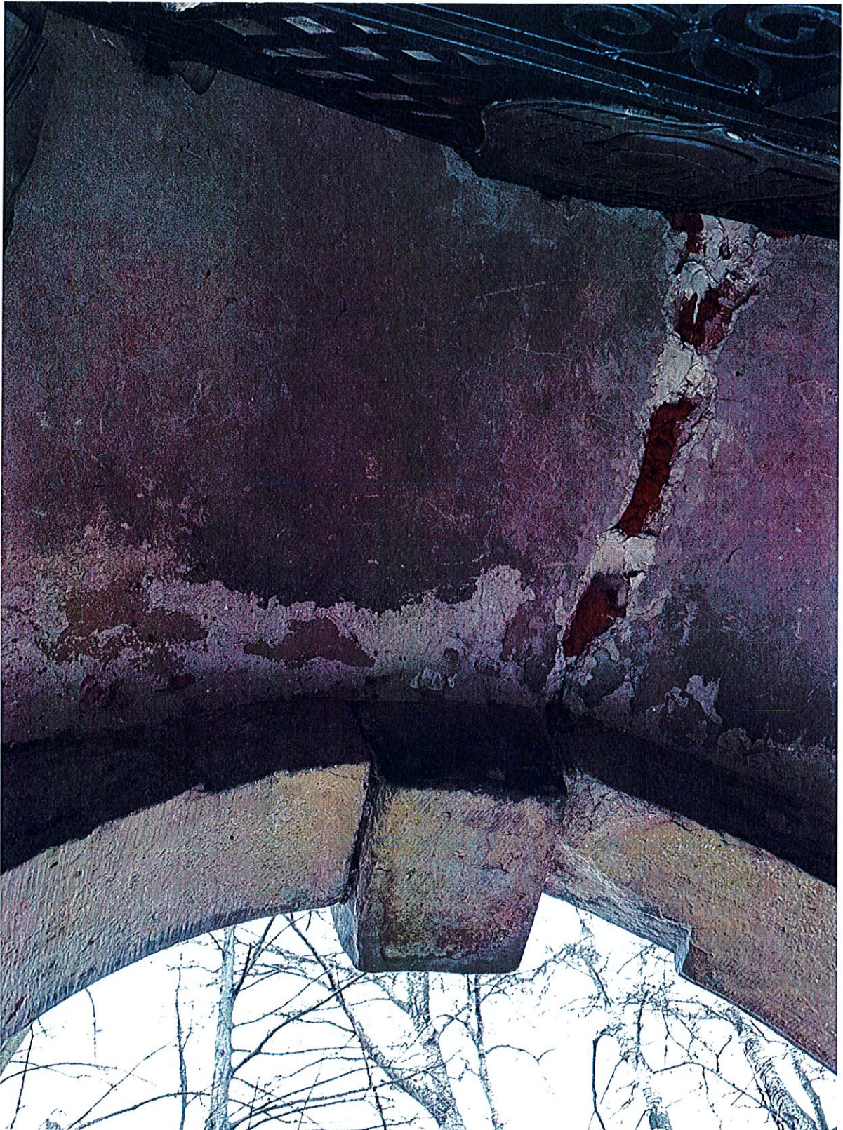
Portal główny - stan z lutego 2024 r. Widok od wewnątrz. Widoczny ubytek formy rzeźbiarskiej; zabrudzenia powierzchni. Autor fot. Katarzyna Pakuła
