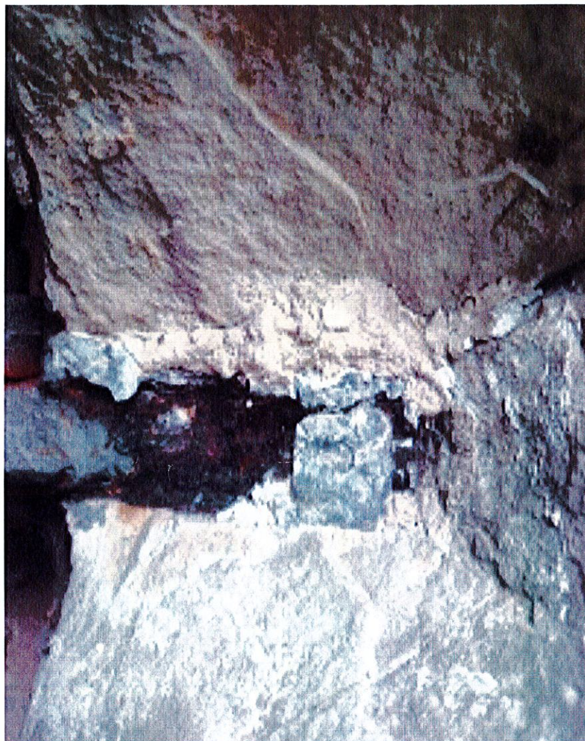
Zbliżenie na odsłonięty zawias drzwi, widoczne ślady korozji oraz ołów, na którym był osadzony element metalowy, a także zaawansowana dezintegracja struktury kamienia, stan z czerwca 2024 r. Autor fot. Iwona Martynowicz
